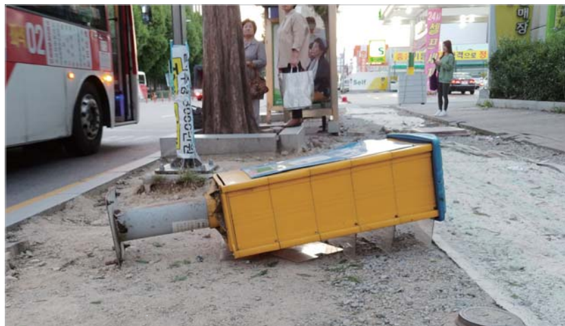
공사 계획 차질로 광주역 인근 자전거도로 공사가 한 달 이상 지연되면서 시민들이 불편을 겪고 있다.
