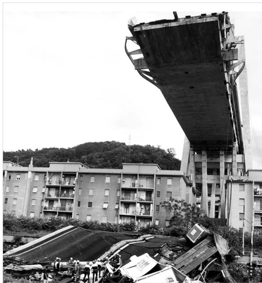
14일(현지시간) 이탈리아 리구리아 주 제노바 A10 고속도로에서 모란디 다리가 붕괴, 소방관들이 구조작업을 펼치고 있다. 현지 언론은 이번 사고로 최소 26명이 숨졌으며 부상자 중에 위독한 사람들이 많아 사망자는 35명에 이를 수 있다고 전했다. 완공된 지 50년 된 이 다리가 무너지면서 다리 위를 달리던 승용차와 트럭 등 약 35대의 차량이 추락한 것으로 알려졌다. /AP-연합뉴스
